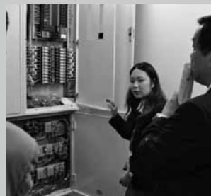
▲既存分電盤に電力監視用機器を取り付け、サーバに電力使用量を送っている。
